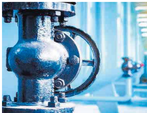
Instalación de tratamiento de agua de una planta.
