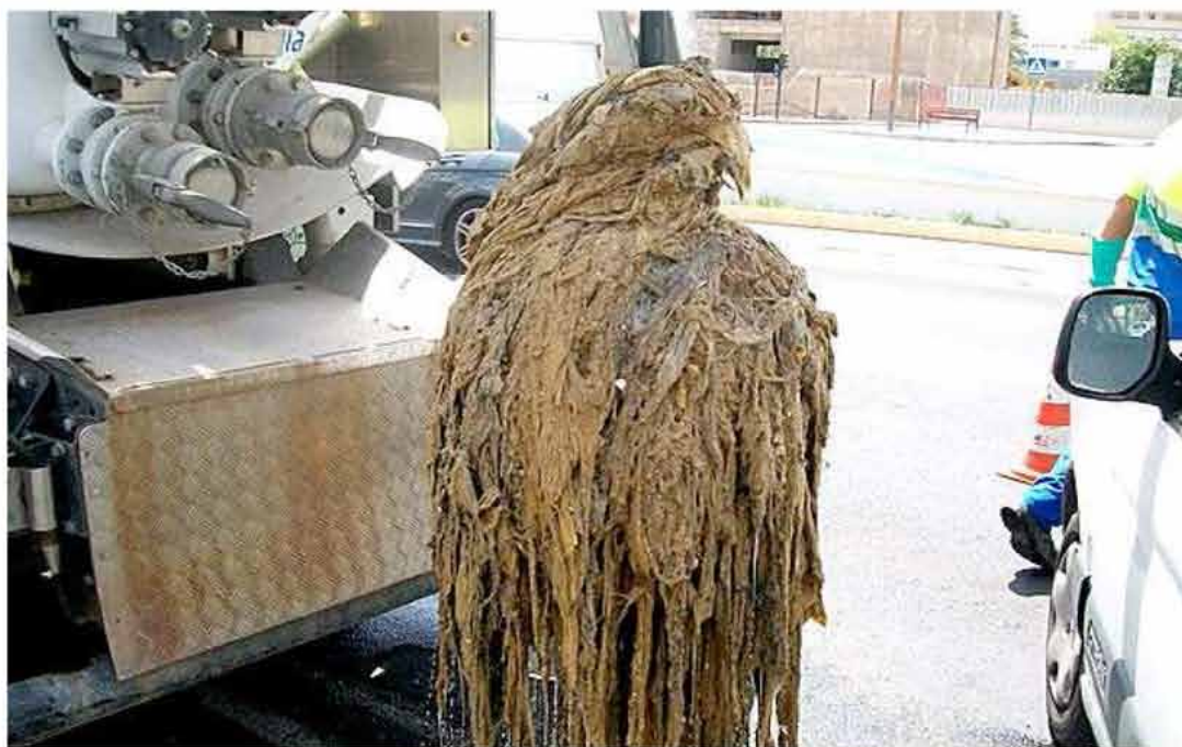
Tirar productos de higiene al retrete genera atascos y averías en la red de tuberías.
